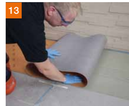
13 Na ca. 40 minuten wordt de ontkoppelingsmat PCI Pecilastic® U met tegellijm PCI Flexmörtel® S2 op de ondergrond gelijmd.
