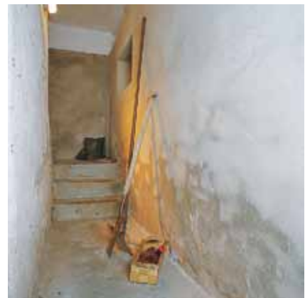
Kelders met schade door vocht en zout voordat deze zijn gesaneerd
