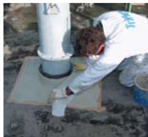
Op het oppervlak de eerste laag Triflex ProDetail aanbrengen. Het Triflex Speciaalvlies volledig blaasvrij aanbrengen.
