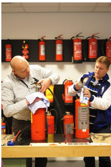
De schuimblusser inwendig controleren
