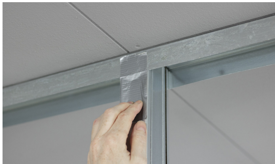
Tijdelijk fixeren van de Knauf MaxSpace staanders aan het UW-profiel met ducttape.
